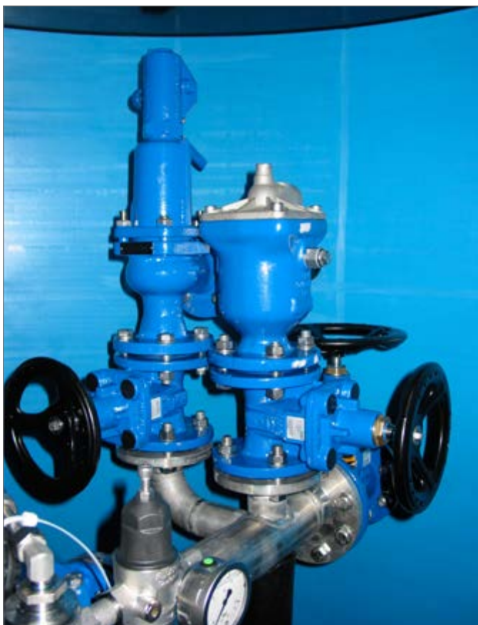
Studnia z reduktorem ciśnienia
