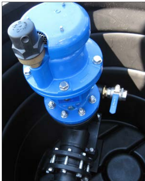
Studnia odpowietrzająco-napowietrzająca z opcją spustu
