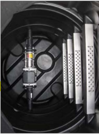
Studnia wodomierzowa ze zintegrowanym miernikiem przepływu MID
