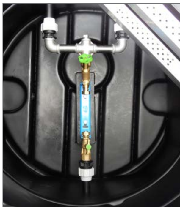
Studnia wodomierzowa z rozdzielaczem
