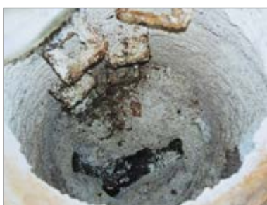
Skorodowana studnia betonowa
